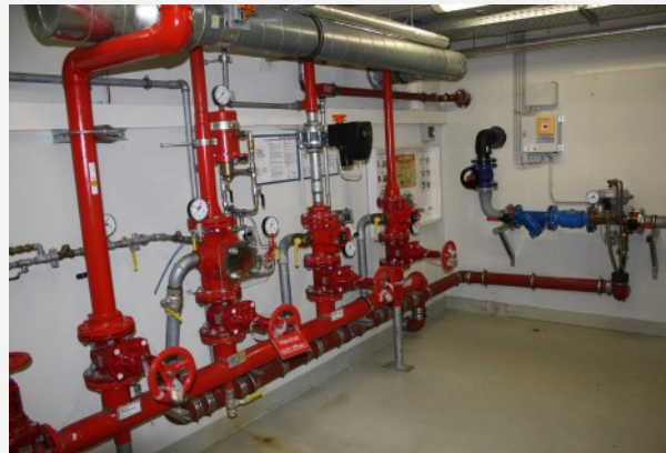
Sprinklerzentrale mit mehreren Alarmventilstationen
