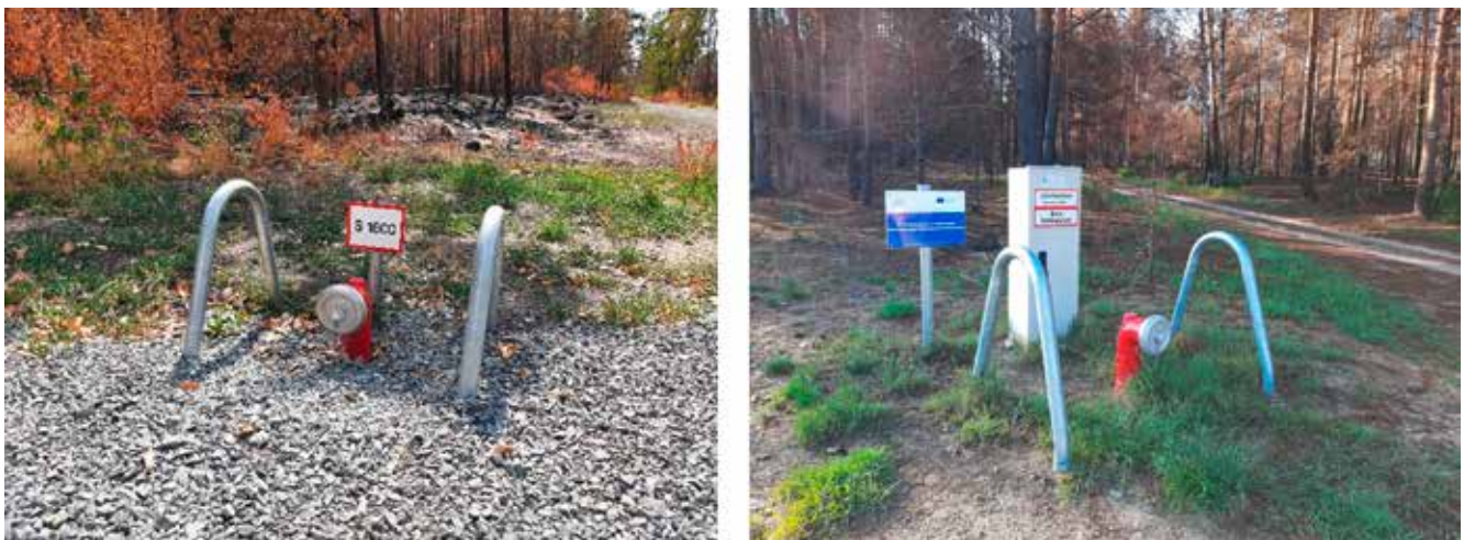
Abbildung 14: Löschwasserentnahmestellen – Flachspiegelbrunnen (links) und Tiefbrunnen mit Pumpe (rechts) (Quelle: LFB)
